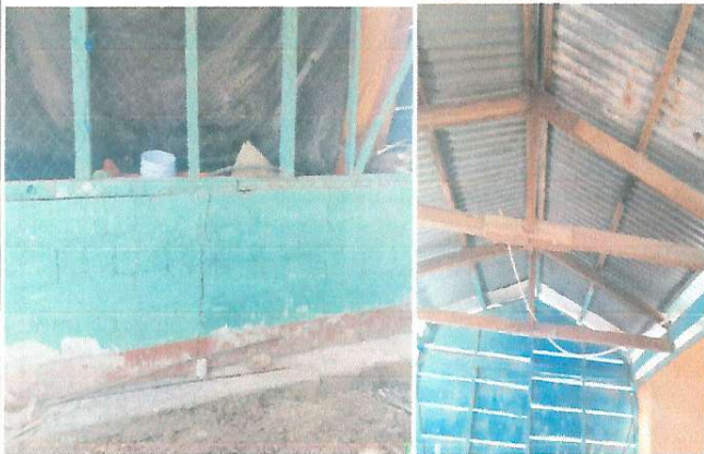
Foto 3: Se cambiara pared de block, ya que se encuentra rajada.
