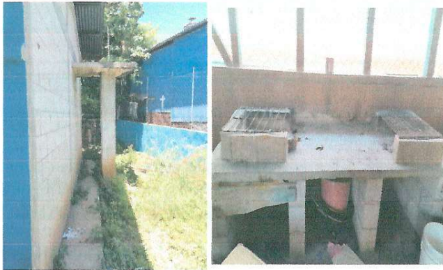
Foto 1: Se cambiara Accesorios de baño, ya que se encuentran en malas condiciones.
