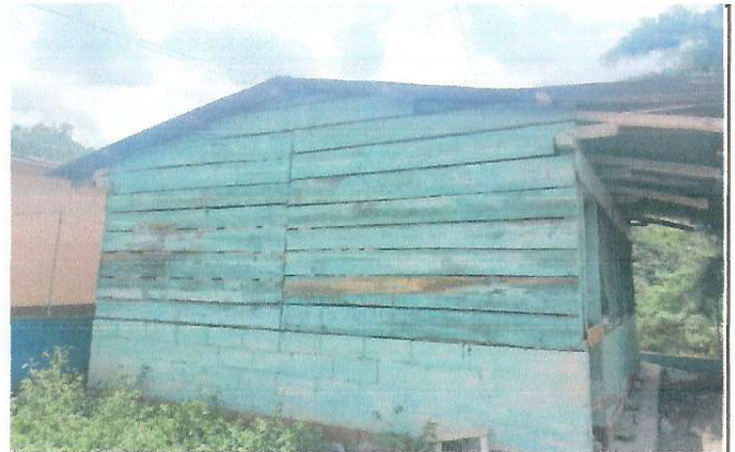
Foto 2: Se realizara pared de block, ya que la madera se encuentra en malas condiciones.
